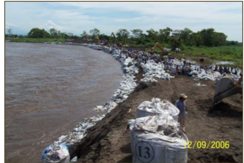
Lo que se hizo antes: Enorme y costoso despliegue de personal y material para protecciones sin rigor técnico.
